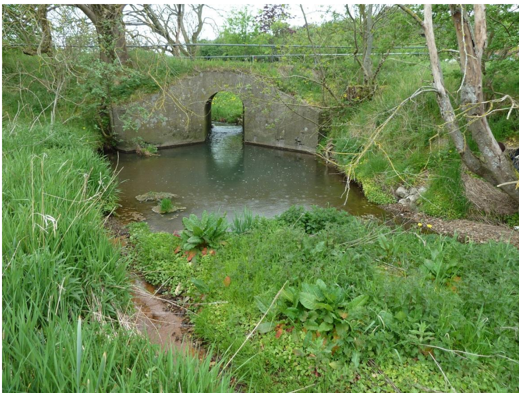
Figur 1.2: Spærring AAL-1198. Udløbsside af Ullerupvej. Den høje vandhastighed gennem broen giver anledning til en kraftig erosion.
